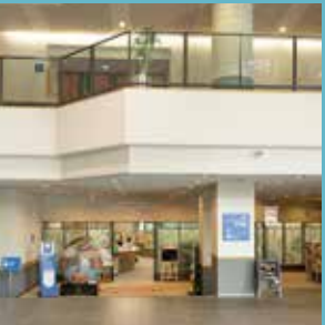
広い施設の補助冷房
